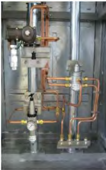
電磁弁・減圧弁収納盤 空気配管チューピング(鋼管6.8Φ)
