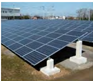
太陽光発電設備
