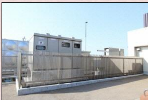
非常用電源設備
