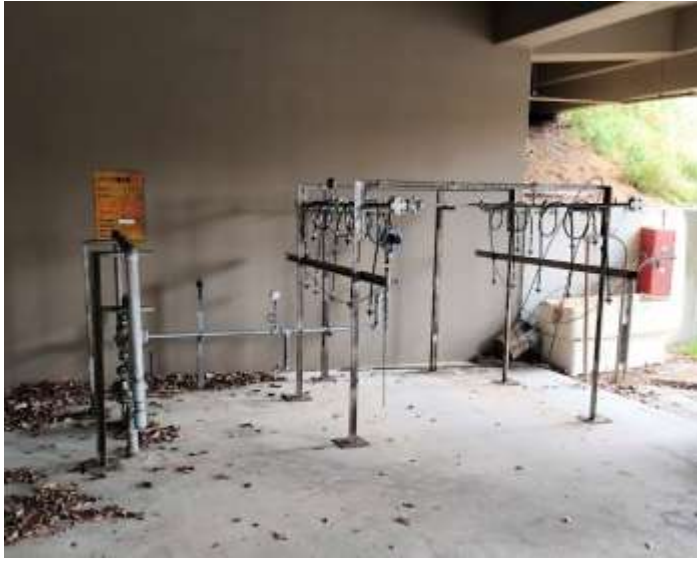
(23) 本館 1 階ガス設備、給湯器
